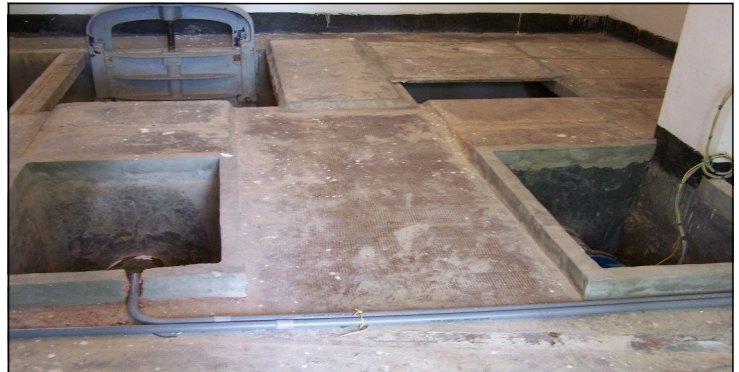
Moghrane : C'est ici dans un bâtiment aujourd'hui moderne, que se fait l'arrivée des deux aqueducs issus des quatre sources captées depuis l'amont, pour ne plus correspondre qu'à un seul canal, en route pour Carthage.
